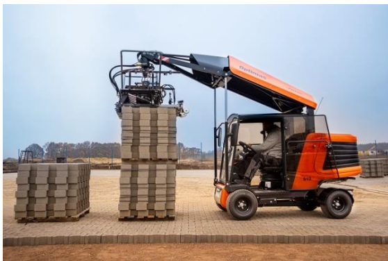
Bild 5: Positivbeispiel für die Lagerung von Steinpaketen auf der Baustelle [Foto: Optimas]
