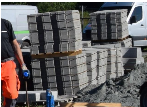
Bild 6: Negativbeispiel für die Lagerung von Steinpaketen auf der Baustelle [Foto: Optimas]
