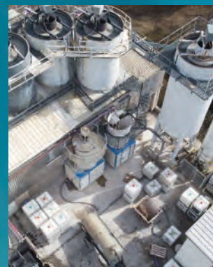
Kläranlage Wasseraufbereitung der Produktionsabwässer
