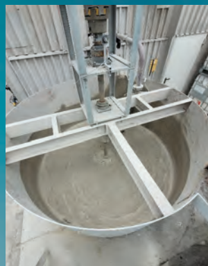
Schlamm-Mischer Schleifschlämme werden hier fraktioniert
